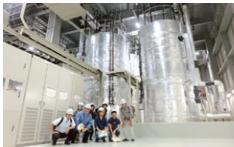
南早来変電所大型蓄電システム前にて
